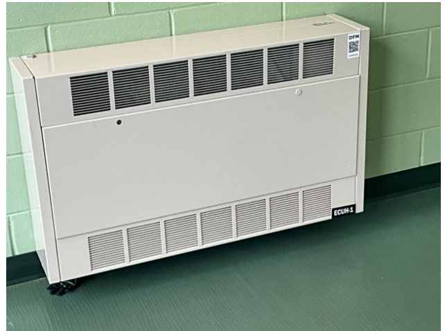
22 - FAN COIL UNIT
